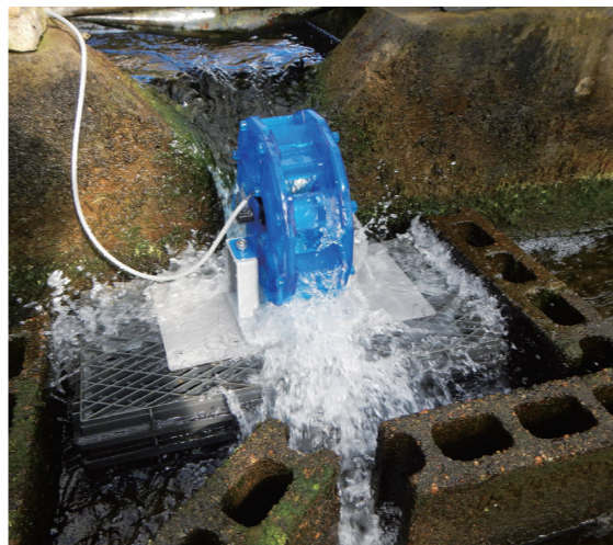
小水力発電実証事業 (達首部地区)
