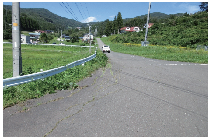
路肩が沈下し危険な塚沢椀川目線
