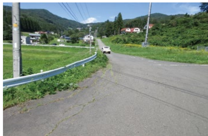
路肩が沈下し危険な塚沢椀川目線
