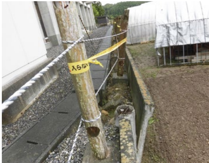
修繕予定の旧土淵中学校体育館脇の擁壁
