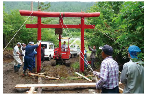
倒壊した愛宕神社の鳥居を更新する地域住民
