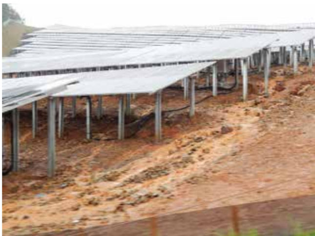
当日の雨で、むき出しとなった地面を雨水が流れだしていた
