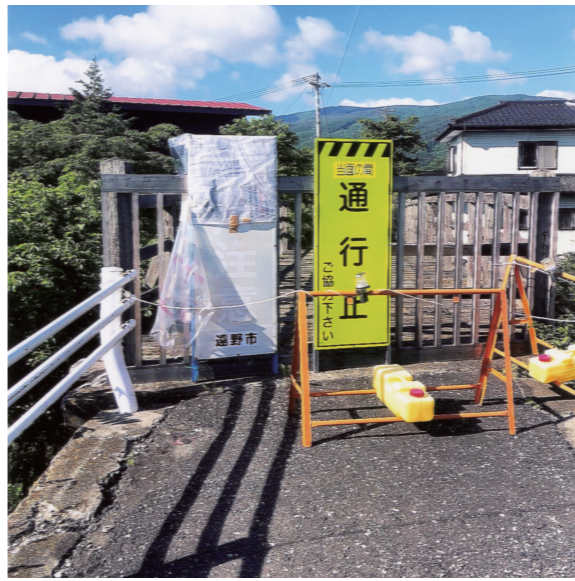
修繕が決まった橋りょう
