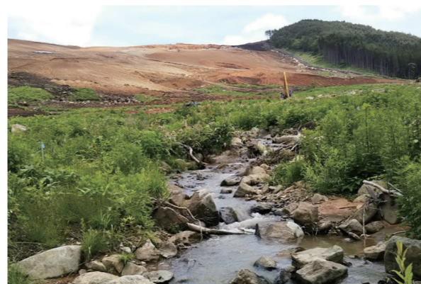
山の表面が削られ、土砂が外山沢に流れ出している工事現場
