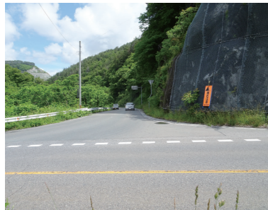
落石の危険性があり、改良工事が待たれる市道「妻の神線」
