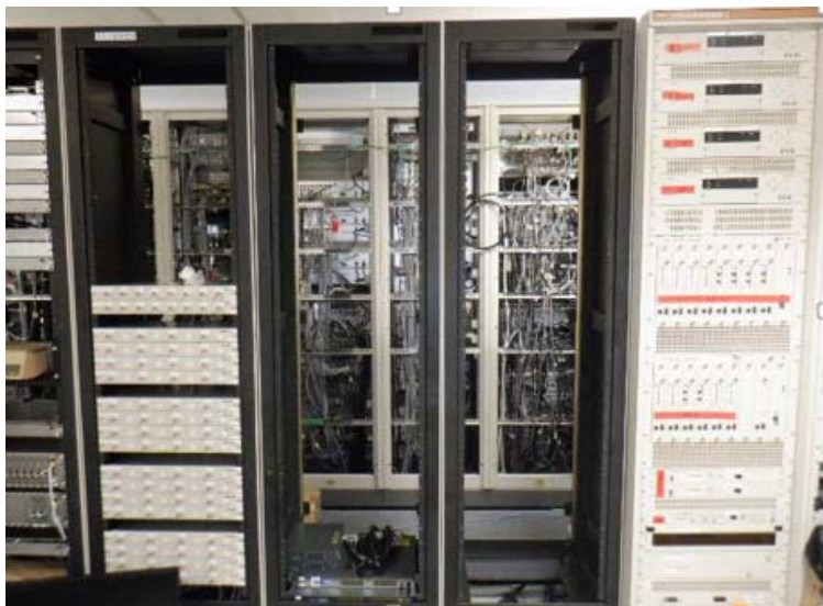
遠野テレビ内機器設置用ラック
