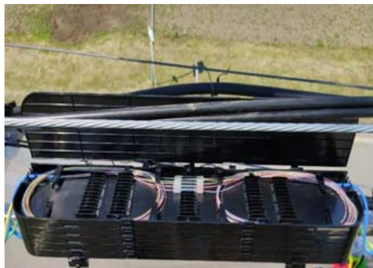
光ファイバケーブル接続用クロージャー内部
