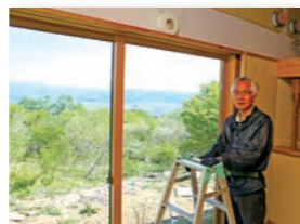
↑建設中の自宅窓からは市内を一望でき、雲海も見ることができます。
