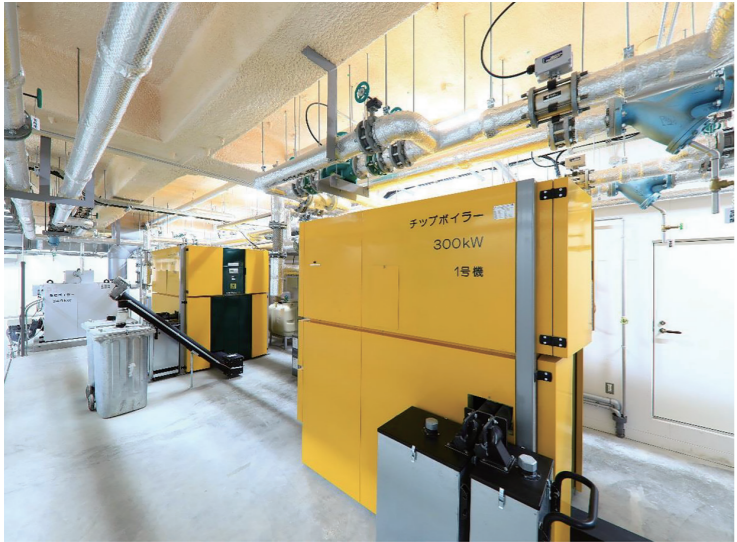
市役所本庁舎地下のチップボイラー
