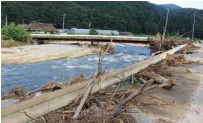
土淵町小烏瀬川の被災状況
