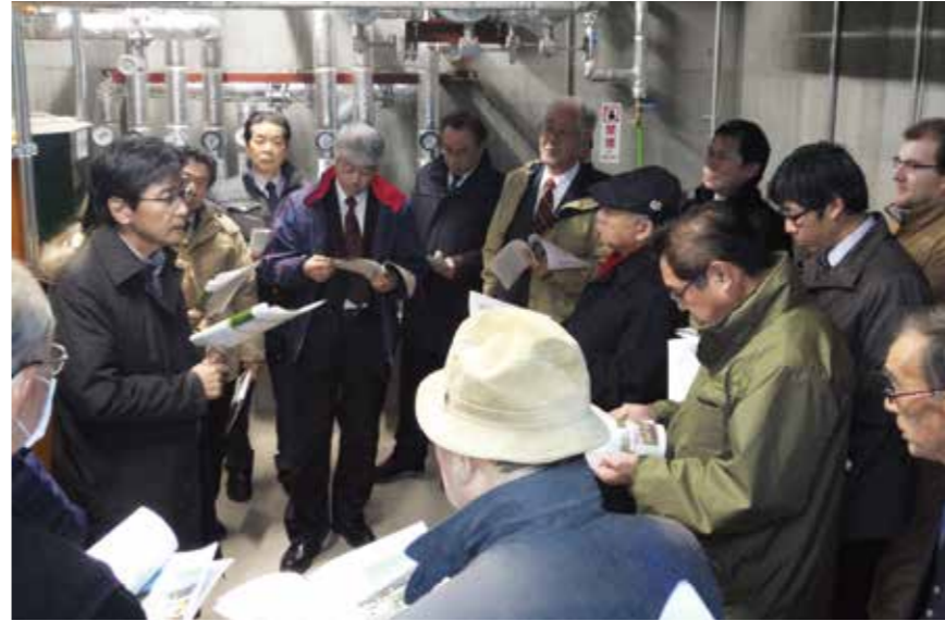
水光園のボイラー室内の様子
