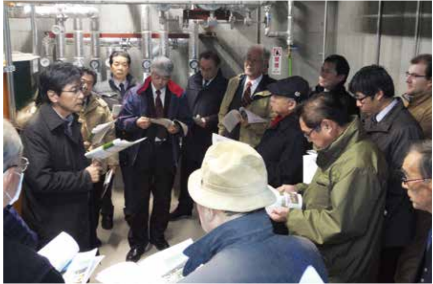
水光園のボイラー室内の様子
