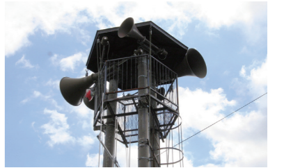
防災無線放送設備
