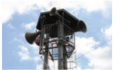
防災無線放送設備
