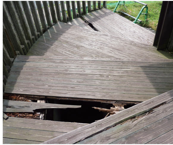
床板に穴があき、立ち入り禁止となっている寺沢高原の展望台
