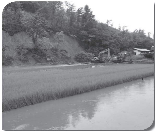
豪雨により土砂崩れが発生した現場と冠水した水田 (宮守町達曾部湯屋地区)
