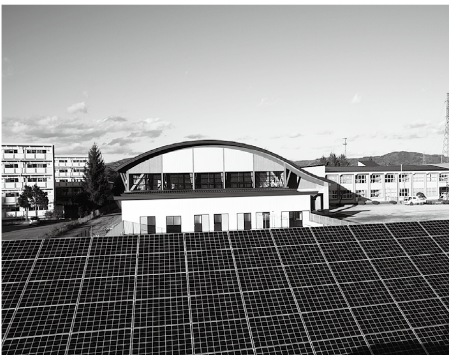
遠野北小学校の太陽光発電パネル
