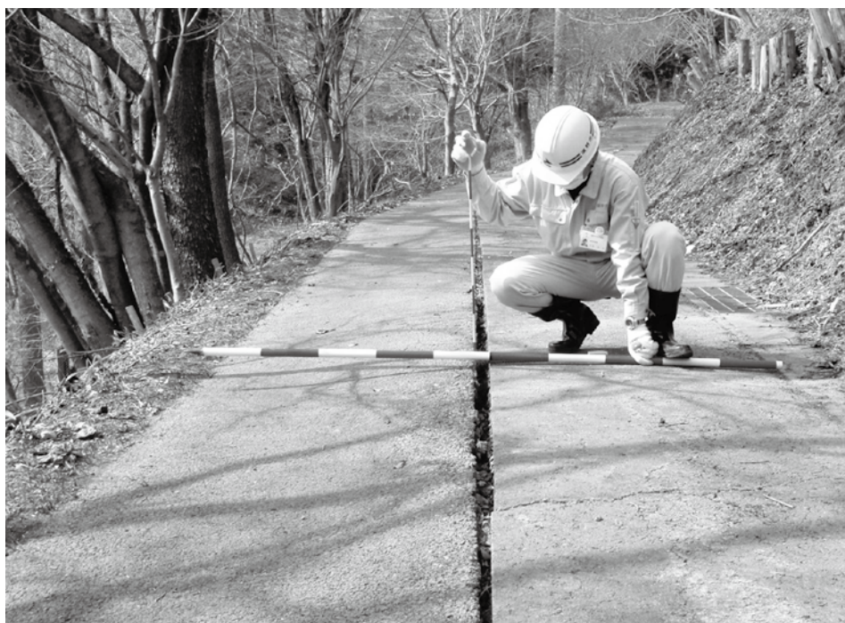
急ピッチで行われた被害状況の確認作業
