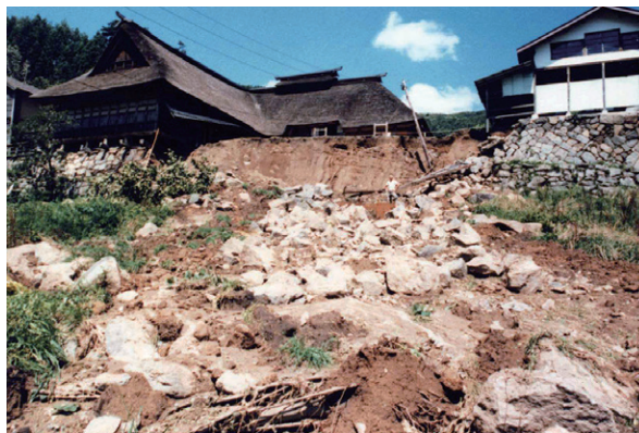
写真 2-12 昭和56年台風による石垣崩壊
