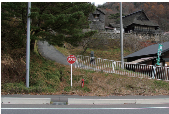
写真 2-11 国道沿いの公共消火栓
