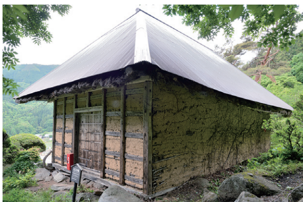
写真 1-14 大工小屋 (修理前)
