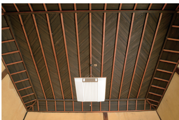
写真 1-8 オクザシキの天井（修理前）
