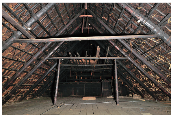
写真 1-5 馬屋の小屋組（修理前）
