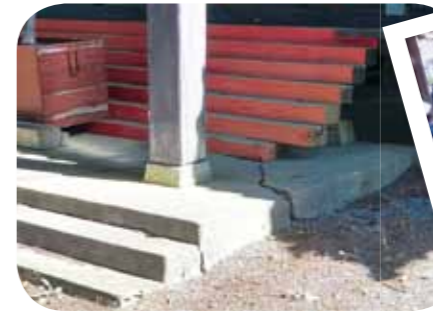
ヒビが入ったコンクリート土間
