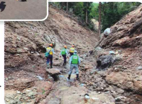
職員を派遣し災害箇所を調査
