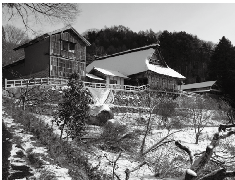
石垣の修復が待たれる千葉家住宅
